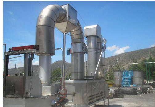
Figura (09) Horno Incinerador – 2006
