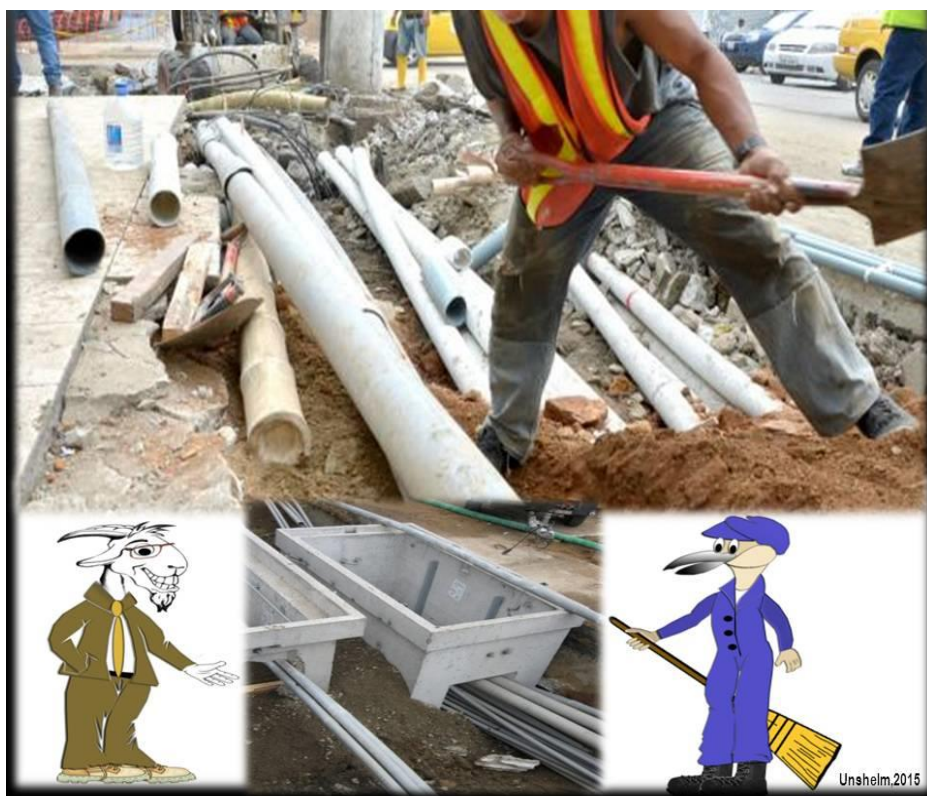
Figura 77: Sistema de Cableado Urbano Subterráneo, Evita la Contaminación Visual.
